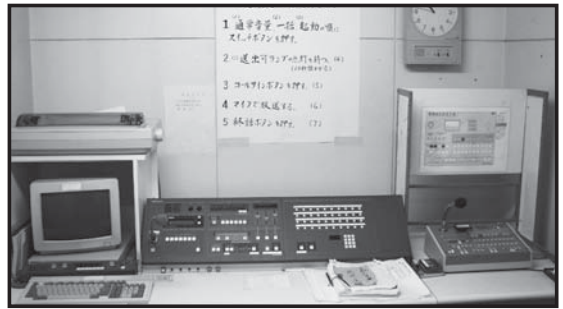
▲市役所大原庁舎内にある防災行政無線室3地域統一されデジタル化となります
