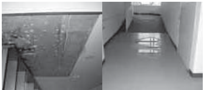
▲国吉中学校体育館 天井の雨漏り及び通路の浸水状況
