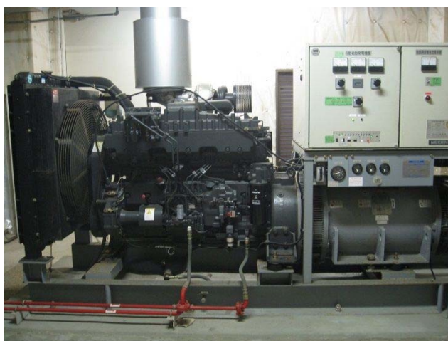
自家発電設備(音羽浄水場)
