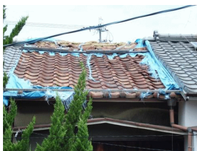
①屋根ふき材の剥離脱落
