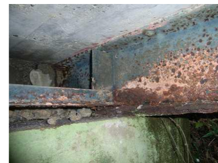
損傷例：鋼桁の腐食
