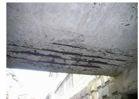
損傷例：コンクリート床版の鉄筋露出
